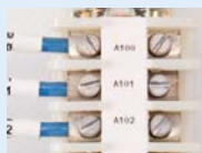
Kennzeichnungen im elektrischen Bereich
