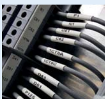
Leitungs- und Kabelkennzeichnung
