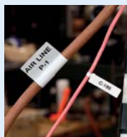
Kennzeichnung im elektrischen Bereich
