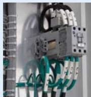
Leitungs- und Kabelkennzeichnung
